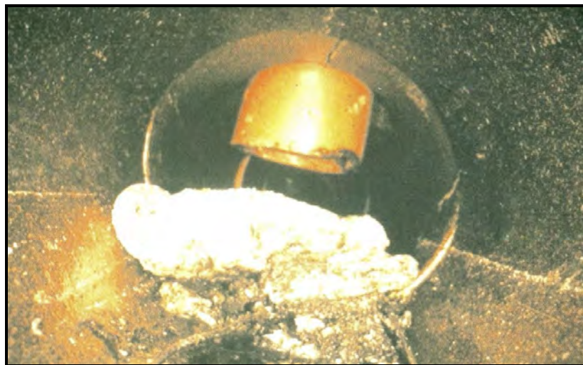
شکل ۶-۲۰-الف- انشعاب مهاجم (Intruding Connection) در ساعت ۱۲
