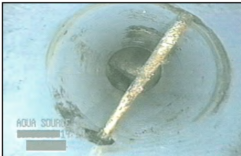
شکل ۶-۱۷-الف - نفوذ مانع به داخل لوله از دیواره‌ی فاضلابرو از ساعت ۱ تا ۷
