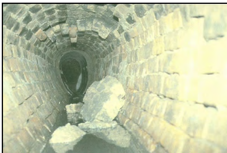
شکل ۶-۱۷-ب - وجود مانع در کف فاضلابرو از نوع آجر یا سایر مصالح بنایی
